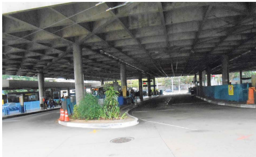
Figura 6 - Plataformas com raios de giro inadequados
